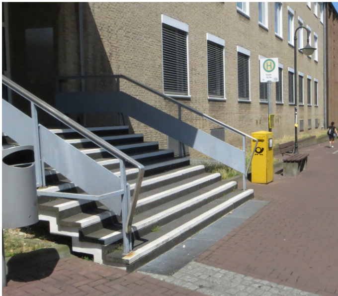
Am Beispiel des alten Postgebäudes an der Hagschen Straße wird die Möglichkeit einer nachträglichen Markierung von Treppentritten deutlich.
